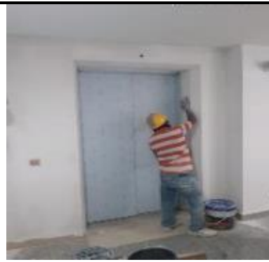
Los ascensores del proyecto se encuentran instalados y funcionando.
