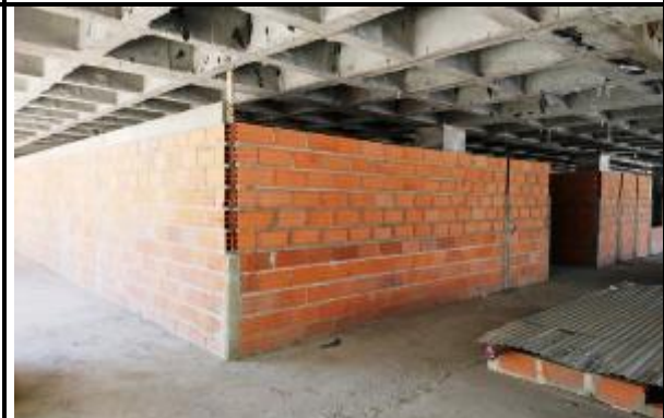
se Continúa levante de muros en bloques Samo sobre placa de primer nivel entre los ejes 3I-6I hasta 3D-6D
