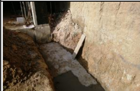
se funde solado de las 2 zarpas que hacen falta por realizar en este sector identificado con el eje 7A
